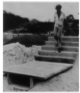
Escadarias drenantes para pedestres
