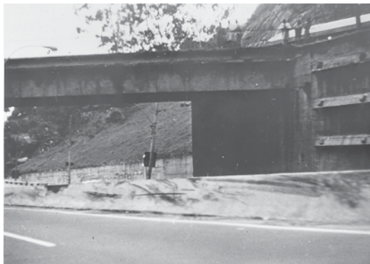
FOTO 4 - Barreiras com perfil NJ no elevado Paulo de Frontin (RJ)
