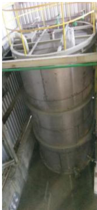
Tanque de armazenagem
