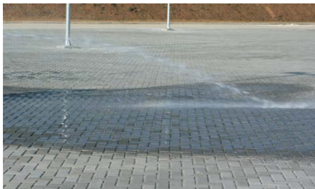
Figura 2 - Pavimento permeável. Não ocorre o escoamento superficial. Praticamente 100% da água infiltra. Pode-se adotar runoff = 0,05
